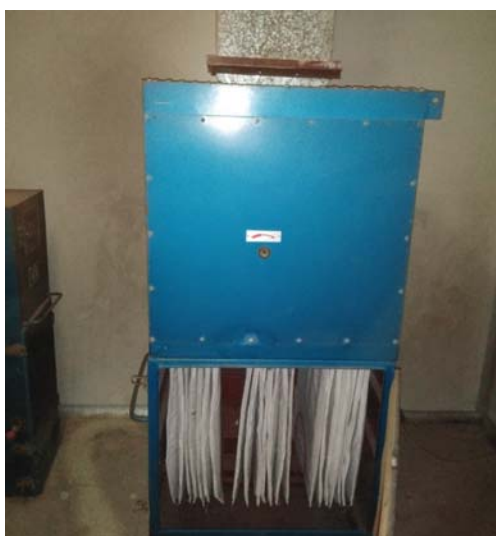
图 4.1.1-5 废气处理设施
